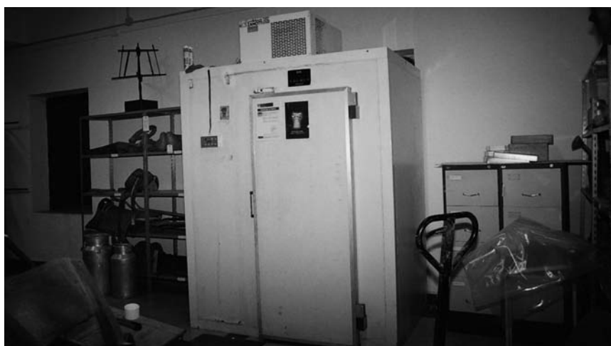
Cámara de shock térmico instalada en el monasterio de Iratxe (2006).
