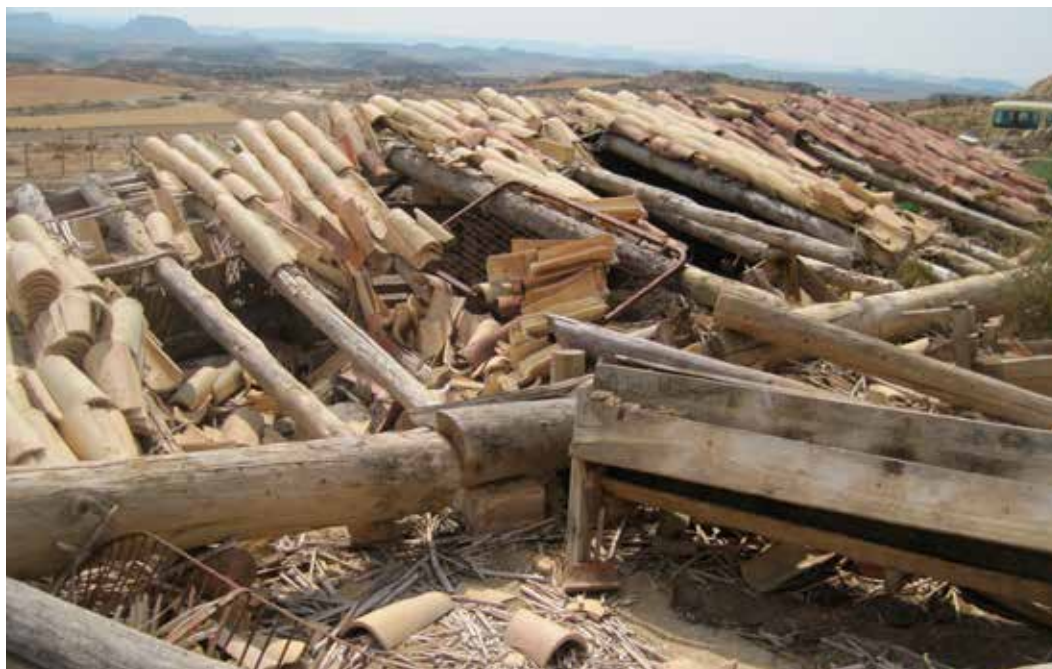
Figura 38. Techumbre totalmente arruinada en el Corral de Cornialto (Javier Nuin).
