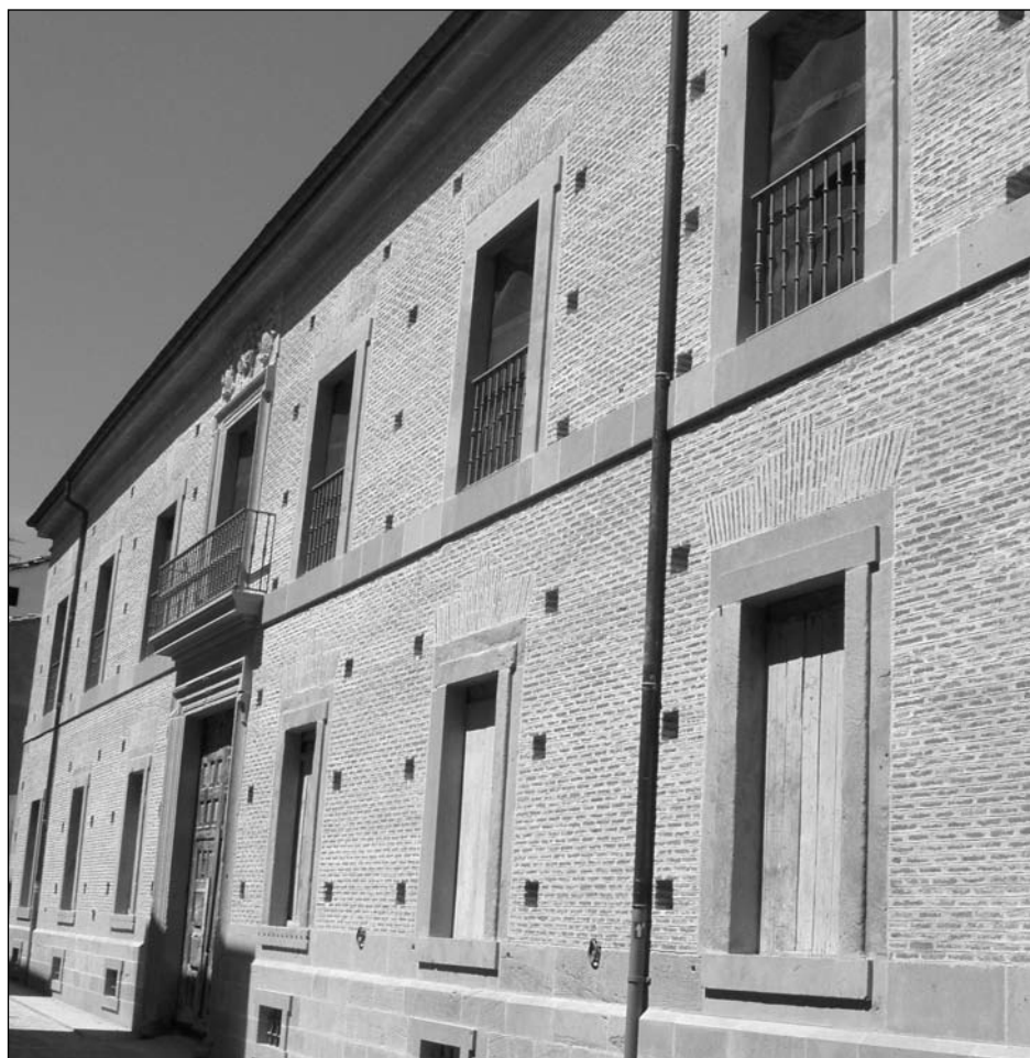
Fachada del Palacio del Gobernador a la Calle de la Rúa, una vez restaurado.
