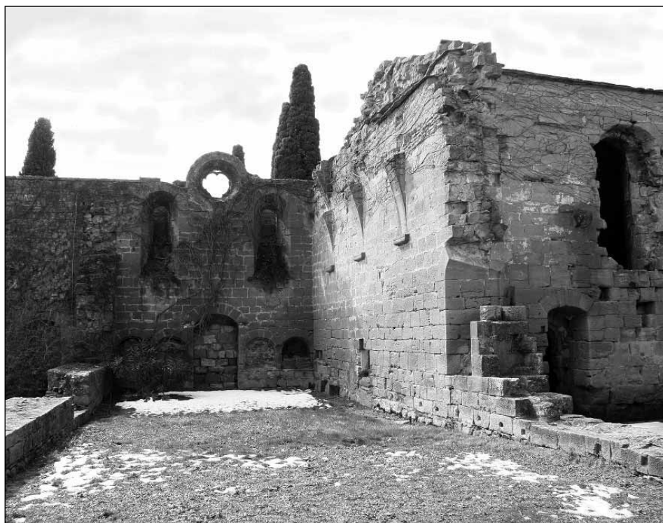
La Oliva. Ruina del Refectorio.
