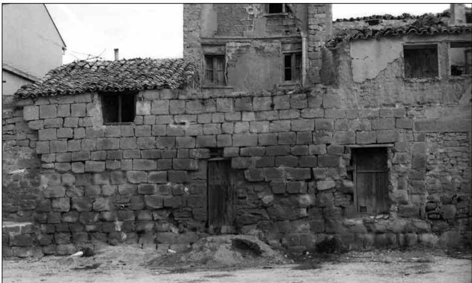
Lienzo de la muralla en el lado noroeste, paralelo al barranco del Castillo. Reutilizado y modificado como pared de vivienda. Derruido en 2008.
