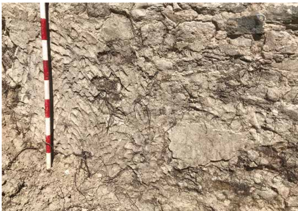
Figura 7. Detalle del enlucido. Marcas de la paleta para fijar el revoque.
