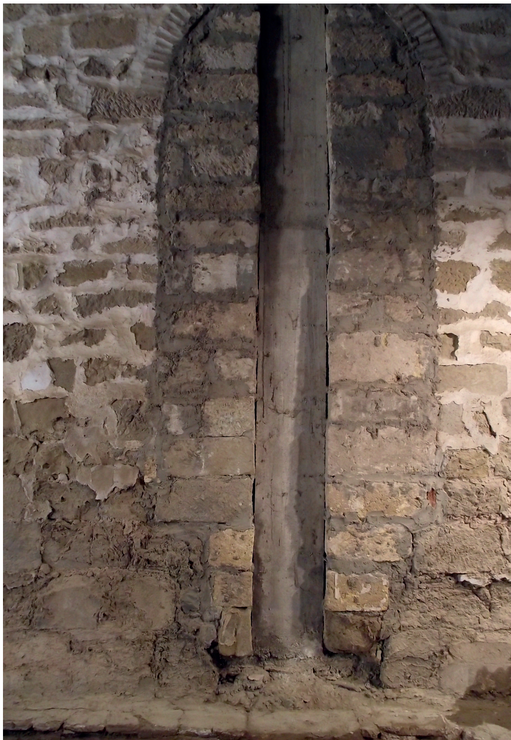
Figura 27. Ventana de la reparación de la esquina sudoeste (fin siglo XIX) cegada con el refuerzo de hormigón (1965-66) (Navark S.L.).
