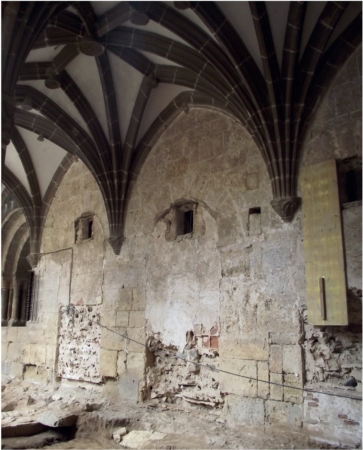
Figura 30. Cerramiento de las puertas de la crujía este (del locutorio, de acceso a la huerta y de la escalera de día) obra de los años 40 del siglo XX (Navark S.L.).
